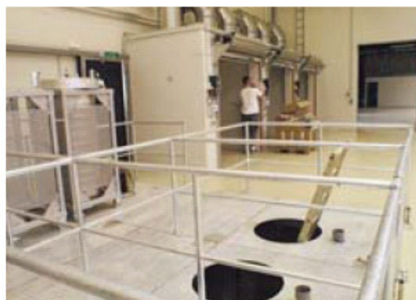
Flammenneu: In den Öfen wird Kupfer erhitzt, bevor es in Kühlkammern (im Hintergrund) auf Produktionstemperatur gebracht wird.
